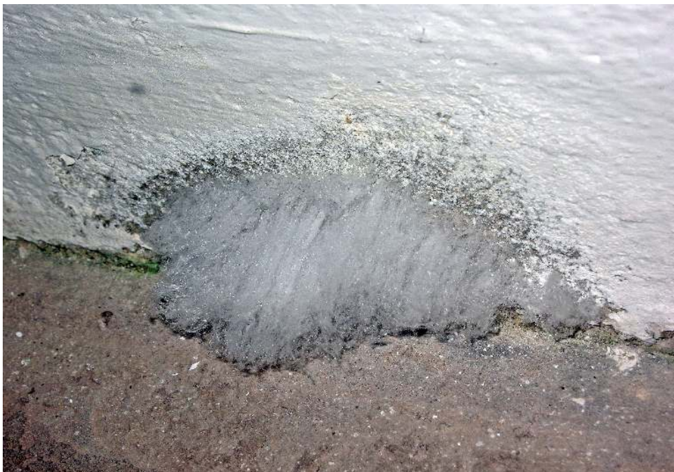
Abb. 120 Salpetersalzausblühung in der Kirche
