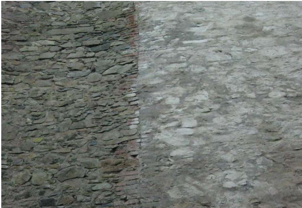
Abb. 64 Burg Falkenstein Schutzschlämme auf Bruchsteinmauerwerk
