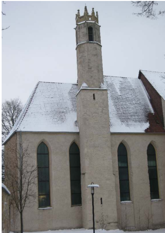
Abb. 63 Kirche des Hildesheimer Römer-Pelizäuseum mit Putzschlämme
