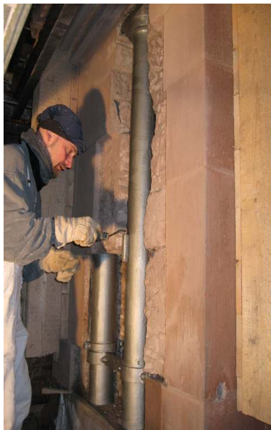
Abb. 197 Rostschutz an historischen Eisenstützen
