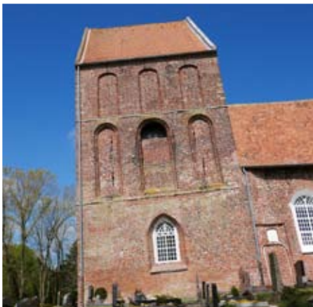
Der schiefe Kirchturm von Suurhusen
